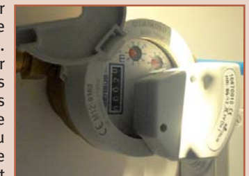
Compteur mesurant la consommation d'eau de lavage
