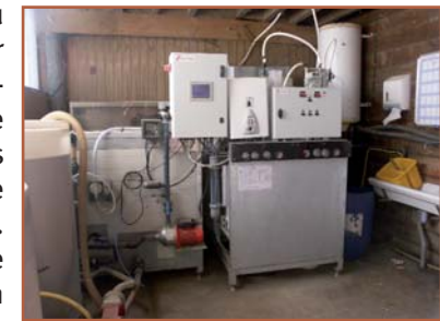
Méthaniseur pilote installé à la station
